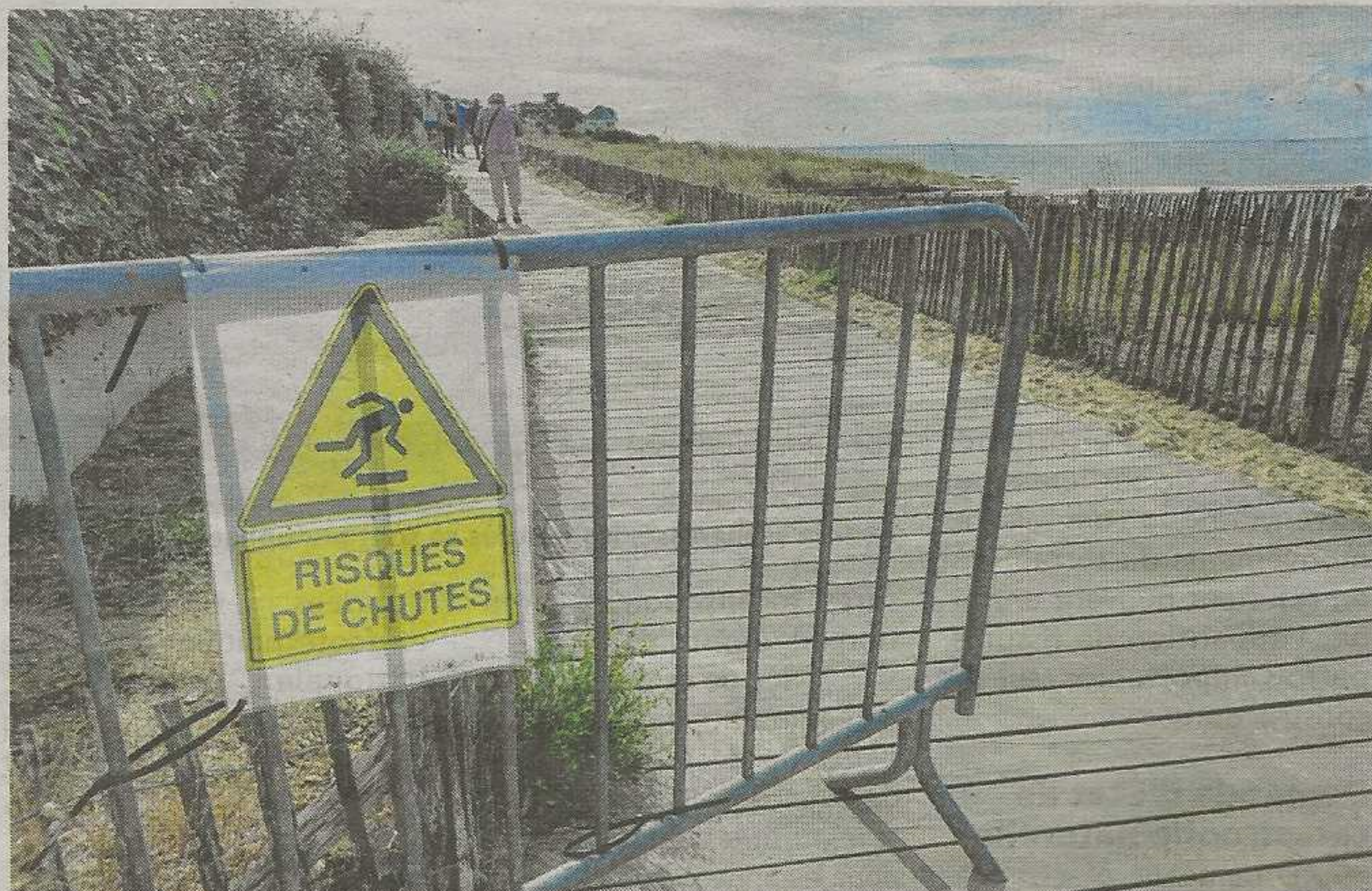
Une partie du chemin côtier est dégradée en attente de réparation SLV
